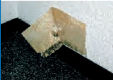
Bild 3: Schimmelpilzbefall unter der Tapete
