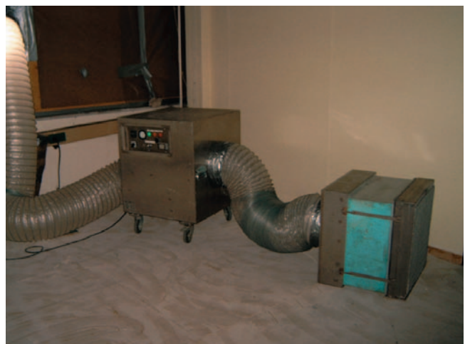
Bild 9: Technische Entlüftung bei starkem Schimmelpilzbefall
