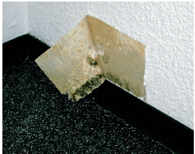
Bild 3: Schimmelpilzbefall unter der Tapete
