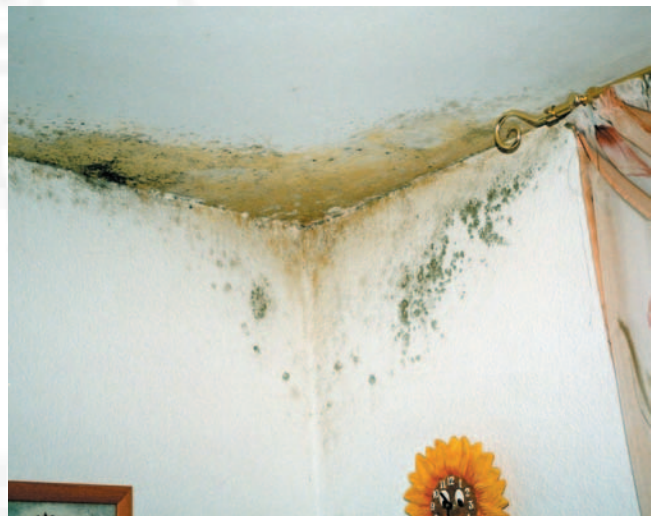
Bild 4: Schimmelpilzbefall undichtes Flachdach
