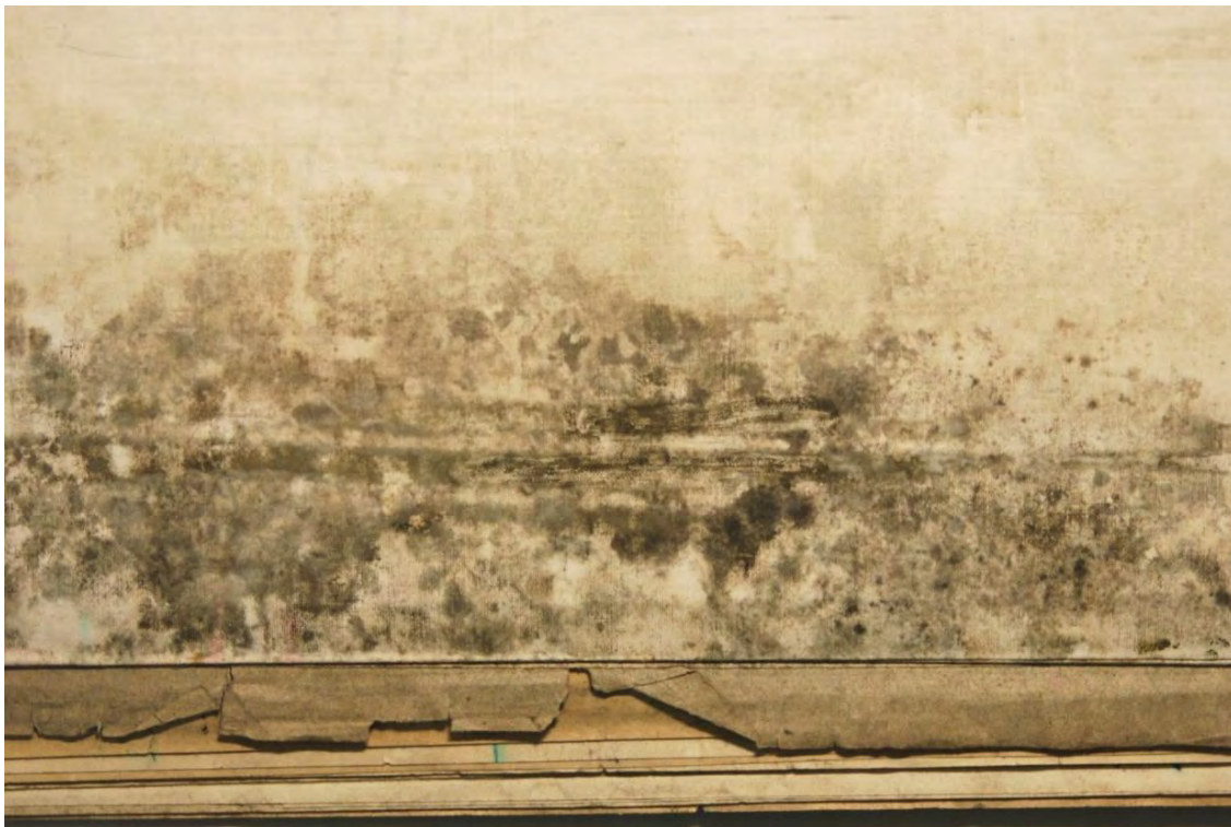
Abb.1: Altschimmelschaden. Foto: Stadtarchiv Chemnitz.
