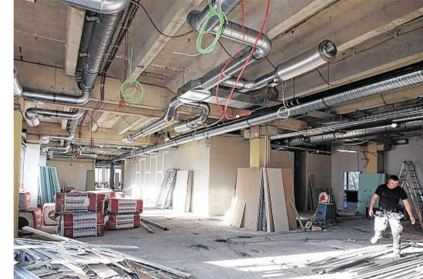
Eine Etage im Flügel A: Trockenbauer haben Wände errichtet, Elektriker Leitungen verlegt, Monteure Lüftungsrohre angebracht. FOTOS: KOSAK
